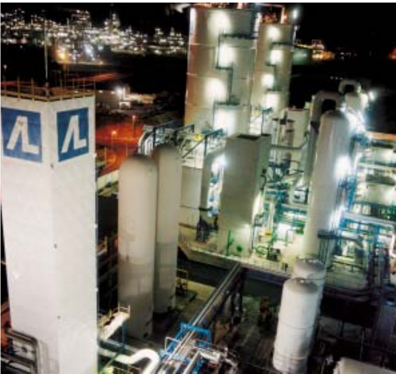
In der Luftzerlegungsanlage von Priolo (Sizilien) wurde ein neues System zur Rückgewinnung von Wasser aus Kondensatoren installiert.
