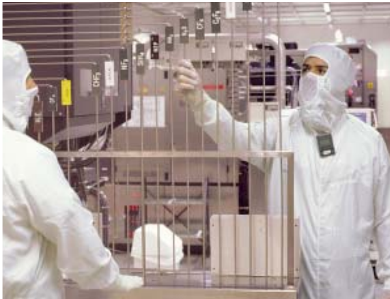
Reinraum: Wartung von Gasetektoren und Analysegeräten
